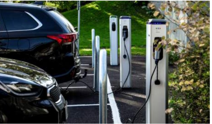
Reference: Ladestationer til elbiler foto: Eon.dk
